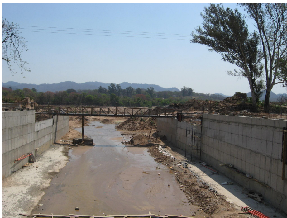
Imagen 4. Obras posteriores al alud ocurrido en la ciudad de Tartagal, Salta
