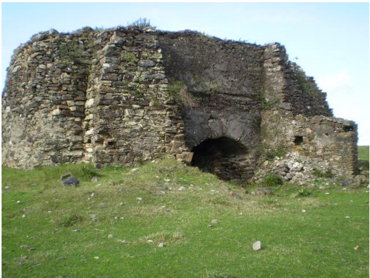
Figura 8 – Acumulación de desechos de cal detrás de los contrafuertes
