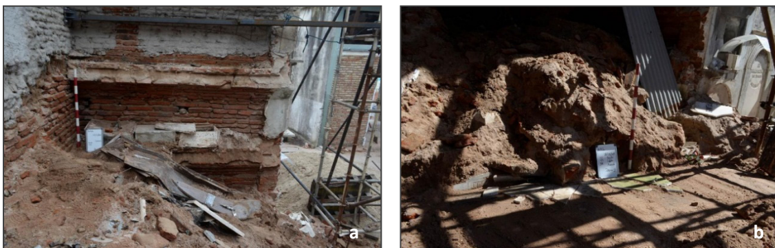
Figura 6. Afección de las estructuras funerarias ocasionada por el derrumbe de los nichos
